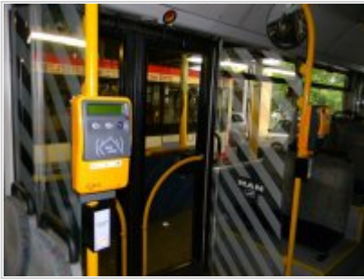
Montaż urządzeń - kasownik e-biletu
